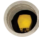
① Can Suyu Vanası
